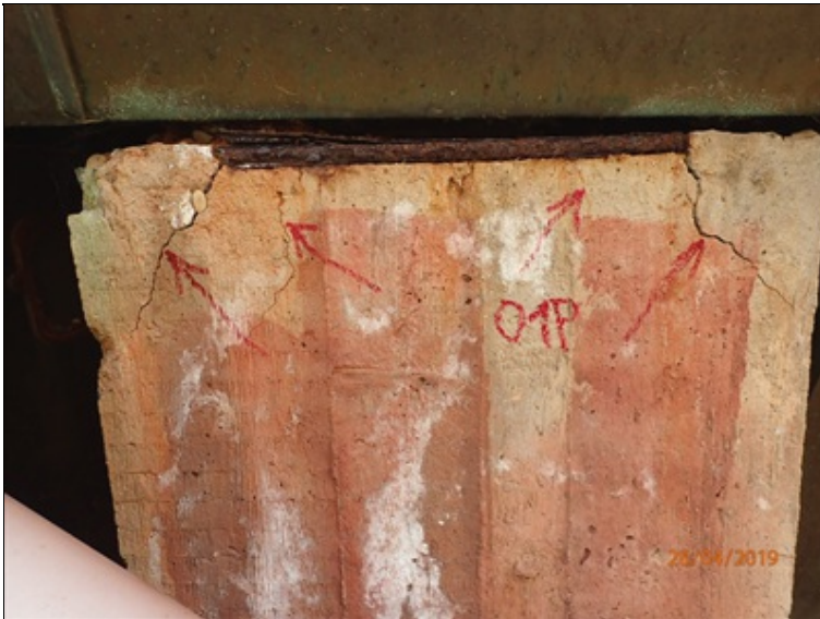
Obdobně potrháný vrchol levého pilířku O3. Označení "O1P" na foto je omyl.
