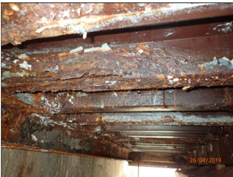
Úsek za O3, podhled žebrové desky mostovky + ocelový příčník podporující její volný konec.
