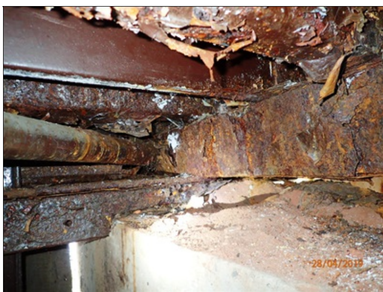
Podhled mostovky před O3, podporový příčník + trubka horizontálního ztužení u levého posuvného ložiska.
