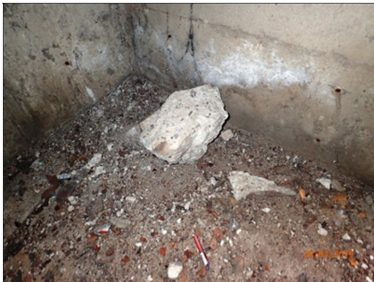
Podlaha komory O1, velký kus betonu.
