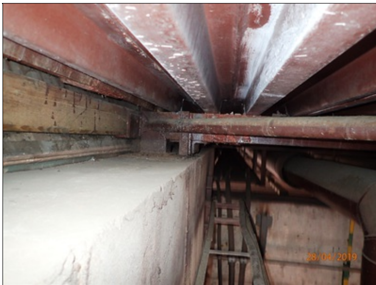
Pilíř P2, vrchol pravé úložné řtěny s pevným ložiskem řměrem do pole 1. Podle loupání nátěru + koroze na podporovém přířníku i zde zatěká.
