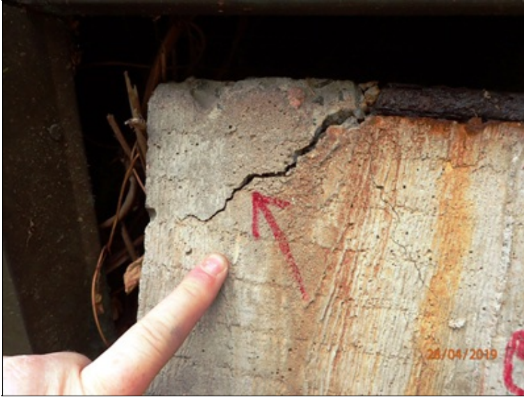
Detail z výše uvedené foto, potrháný vrchol pravého pilířku O3.
