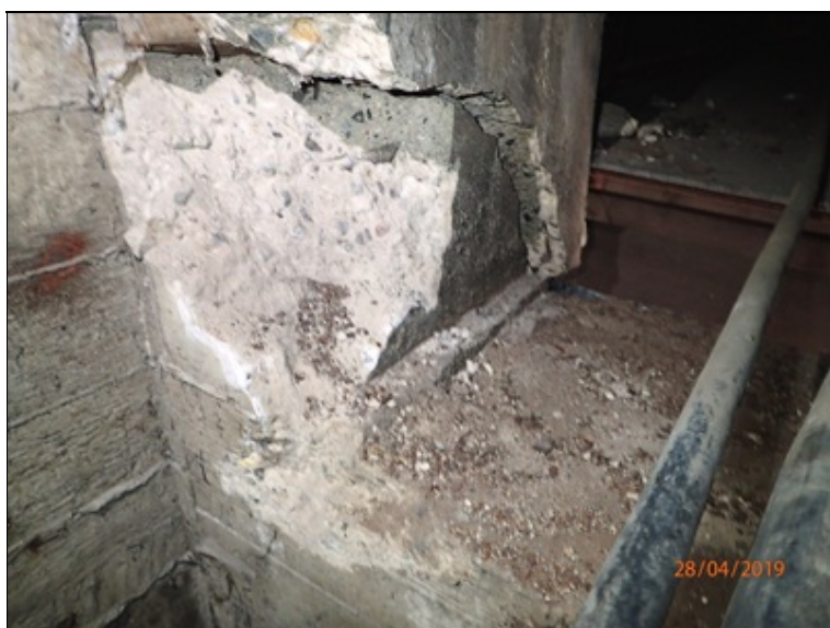
Komora O1, detail z výše uvedené foto, zde se oddělil nalezený kus betonu.
