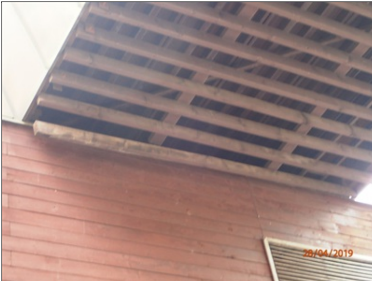
Pole 2, pohled vzhůru na krycí rošt technologického prostoru podél stěny "energocentra".
